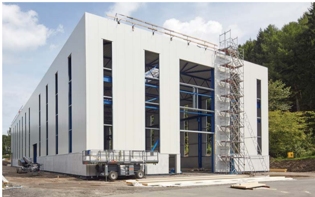
Neuer Hingucker in Lindlar: Die neue, 2.400 Quadratmeter große Halle verfügt über eine Krankkapazität von 80 Tonnen.
